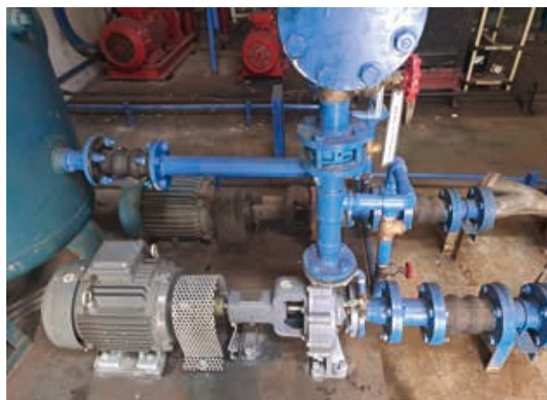
稼働見直しのポンプ
